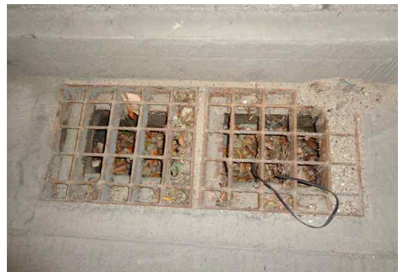
배수시설 SPAN.101 집수구 토사퇴적
