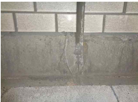
라이닝 SPAN.93 균열(0.3mm 이상)
