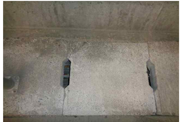
공동구 SPAN.95 덮개 파손
