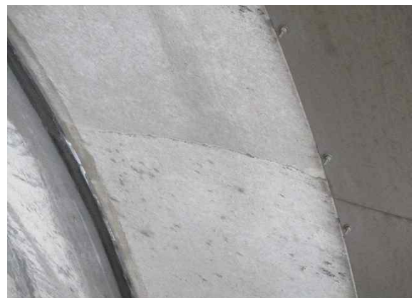
라이닝 SPAN.109 균열(0.3mm 미만)
