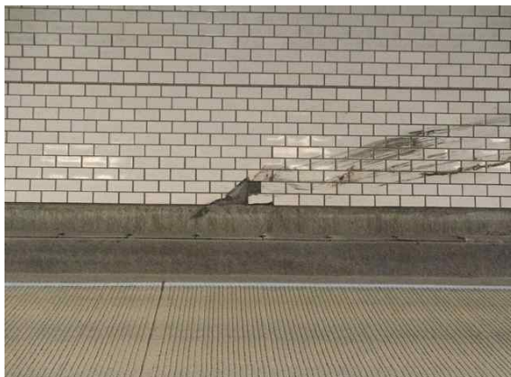
측벽부 SPAN.8 타일 탈락
