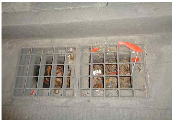
배수시설 SPAN.56 집수구 토사퇴적
