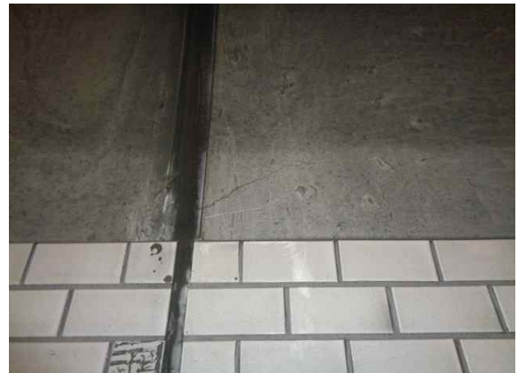
라이닝 SPAN.81 균열(0.3mm 이상)
