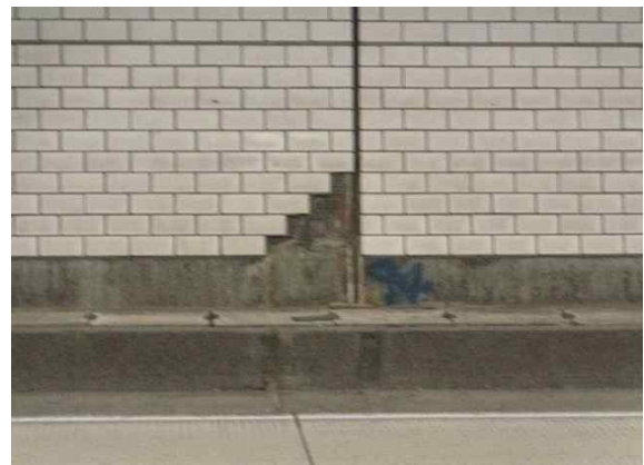
측벽부 SPAN.95 타일 탈락
