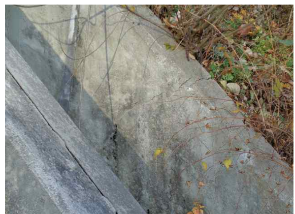
종점부 도수로 균열(0.3mm 이상)
