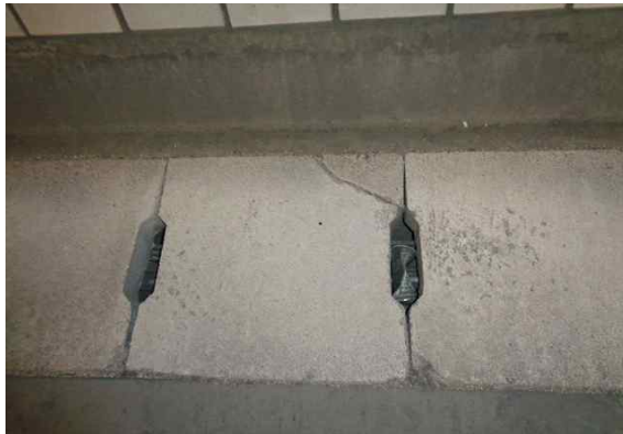
공동구 SPAN.42 덮개 파손
