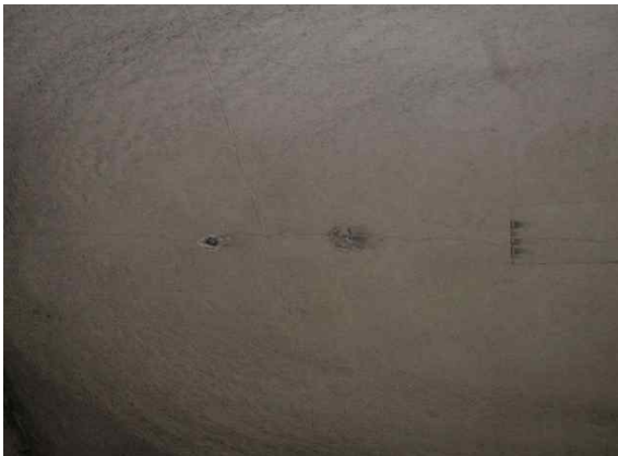
라이닝 SPAN.74 균열(0.3mm 미만)
