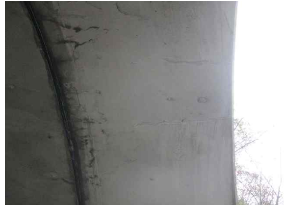
라이닝 SPAN.0 균열부 백태
